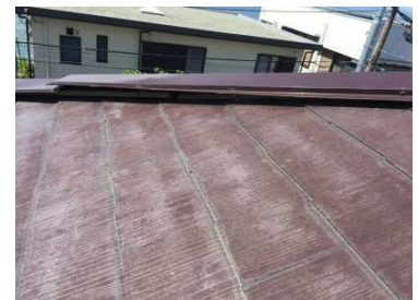
屋根板金の浮き
